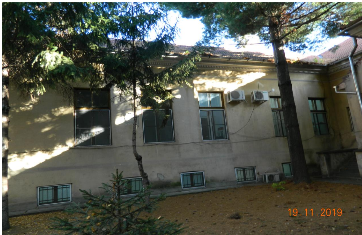
FOTO 3.NICI O FEREASTRĂ NU ARE GLAFUL DE PROTECȚIE ,ZONA DE PROTECȚIE LA SOCLU PENTRU STROP NU ESTE REALIZATĂ,IGRASIA A DISTRUS TENCUIELILE.
