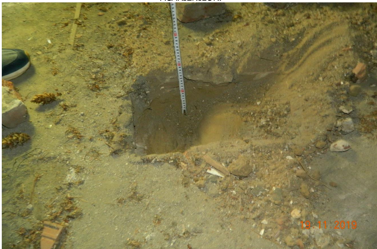
FOTO 12. UMLUTURI LA PLANȘUL PODULUI ,PARDOSELI DIN ZIDĂRIE DIN CĂĂMIDĂ PLINĂ CARE SE VOR DESFACE ȘI SE VA ÎNLOCUI CU THERMOBETON
