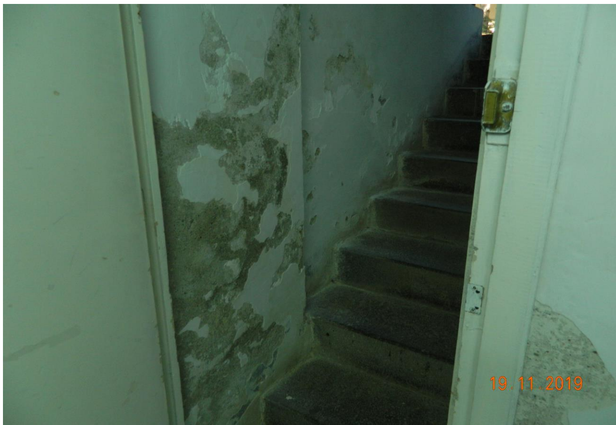
FOTO 7. IGRASIE LA PEREȚII SUBSOLULUI ,IZOLAȚIA EFECTUATĂ FĂRĂ A FI EFICIENTĂ.
