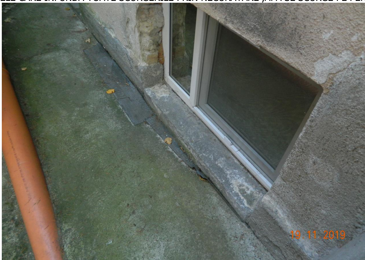
FOTO 2. INTERVENȚIE LA FERESTRELE DEMISOLULUI ,FĂRĂ PROTECȚIA NECESARĂ LA STROP ȘI FĂRĂ GLAFURI LA FERESTRE.IZOLAȚIA HIDROFUGĂ ESTE EXECUTĂ EMPIRIC.
