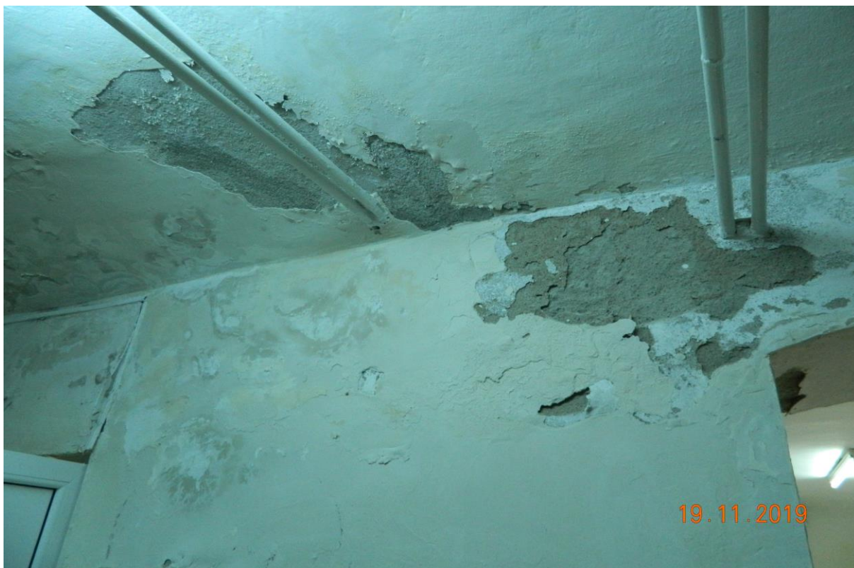
FOTO 5. INFILTRAȚII DE LA INSTALAȚIILE ÎNGLOBATE CARE NU MAI IZOLEAZĂ CORESPUNZĂTOR ȘI CARE NU AU FOST ÎNLOCUITE DE LA CONFEȚIONAREA INSTALAȚIILOR DE SANITARE ȘI DE ÎNCĂLZIRE
