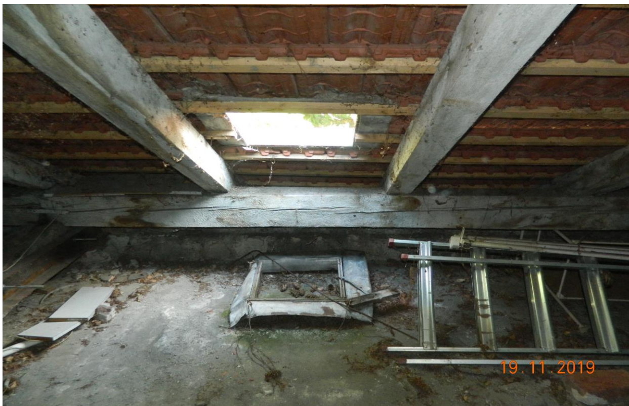
FOTO 11. LUMINATOR CARE NU S-A MAI MONTAT DUPĂ REPARAȚII PLOUĂ DIRECT PE PLANȘUL DE LEMN PESTE PARTER.S-A SCHIMBAT ÎNVELITOAREA ȘI ȘIPCILE,NU S-A IGNIFUGAT STRUCTURA DE LEMN ȘI NU S-A TRATAT CONTRA ACARIENILOR.
