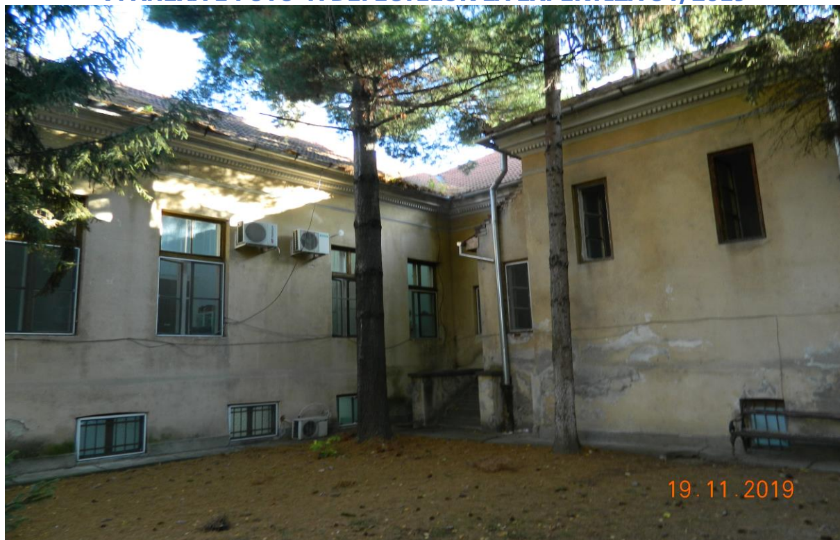
FOTO 1. CURTEA INTERIOARĂ A CLĂDIRII CARE SE VA MODERNIZA BRAZII CARE PRODUC ACELE CARE ÎNFUNDĂ TOATE SCURGERILE PRIN NECURĂȚARE ,APA SE SCURGE PE PEREȚI
