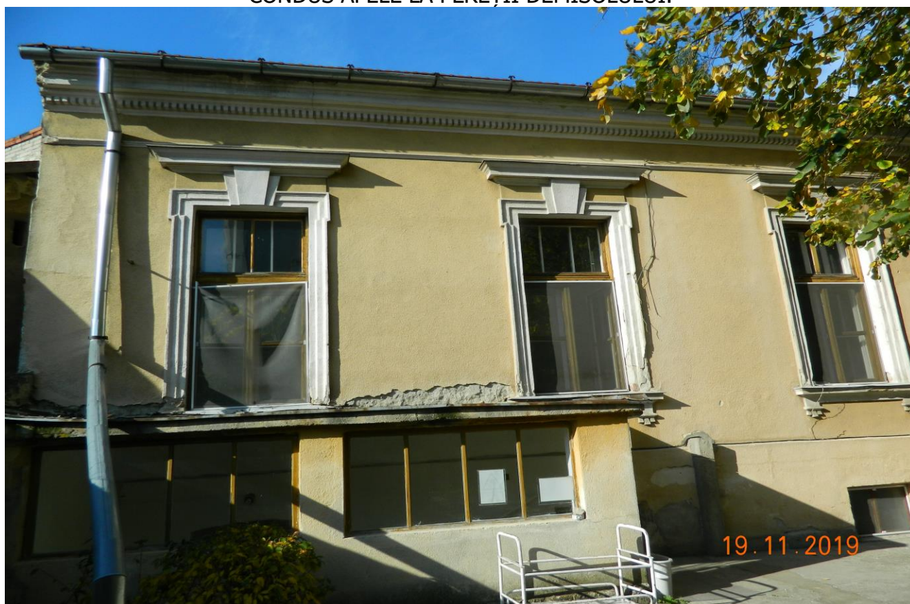
FOTO 10. LIPSA GLAFULUI DE TABLĂ LA ALIPIREA COPERTINEI AU CONDUS LA AFETAREA PERETELUI DE INFILTRAȚIILE APEI PLUVIALE CARE VOR TREBUI CORECTATE ODATĂ CU INTERVENȚIA PROPUȘĂ
