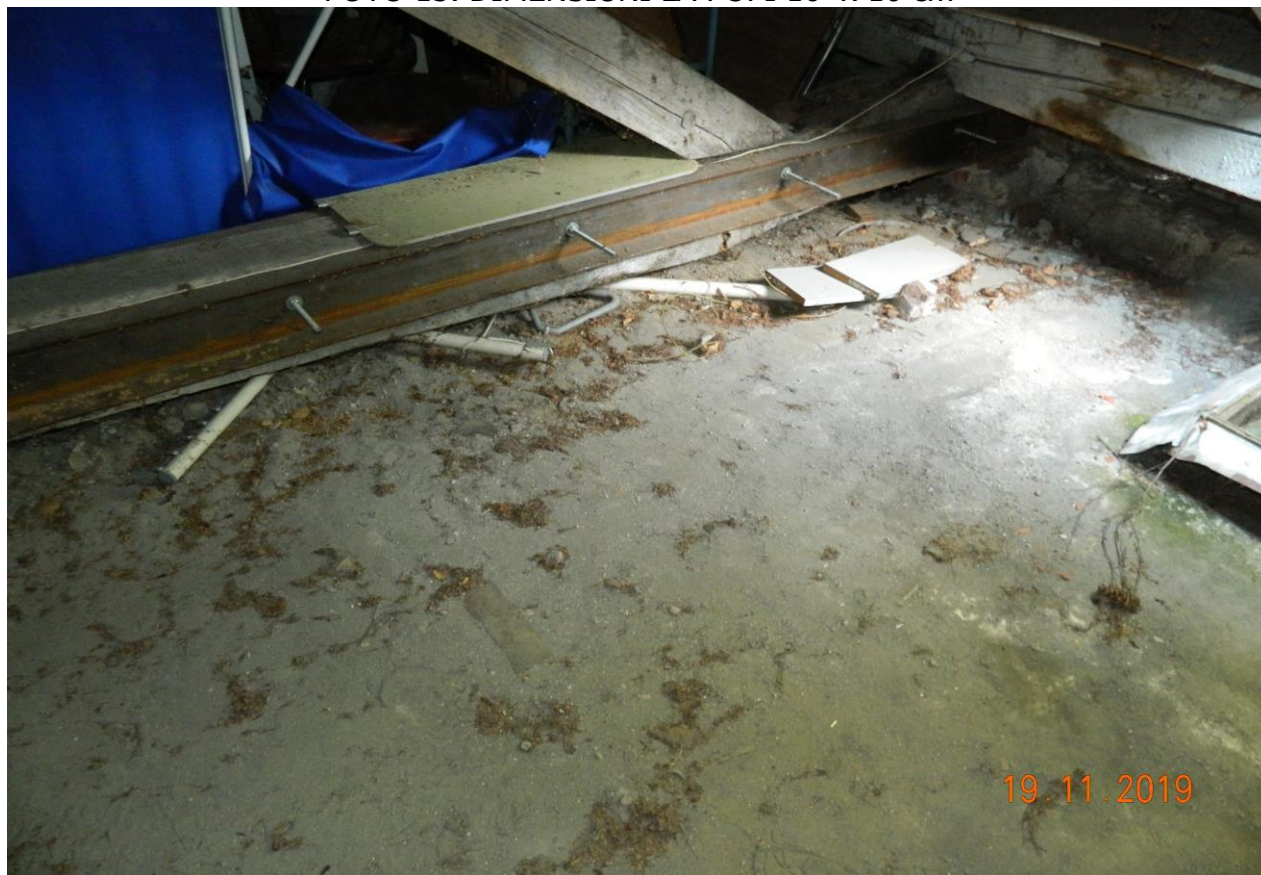
FOTO 16. CONSOLIDARE TALPĂ CARE S-A RUPT DIN CAUZA PUTREGAIULUI CA URMARE A INFILTRAȚIILOR DIN APA PLUIALĂ.
