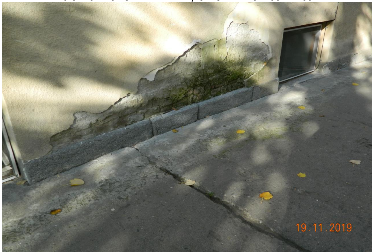
FOTO 4. ACELAȘI FENOMEN CA ȘI ÎN FOTO 3 LA TOATE FERESTRELE DIN SUBSOLUL CLĂDIRII.REZOLVAREA IZOLĂRII FERESTRELOR TREBUIE FĂCUTĂ CU CURTE DE LUMINĂ IAR IZOLAȚIA TREBUIE RIDICATĂ LA SOCLUL PERETELUI MINIM 30 CM DE LA COTA SISTEMATIZATĂ, NU CA ȘI CEA REALIZATĂ ACUM
