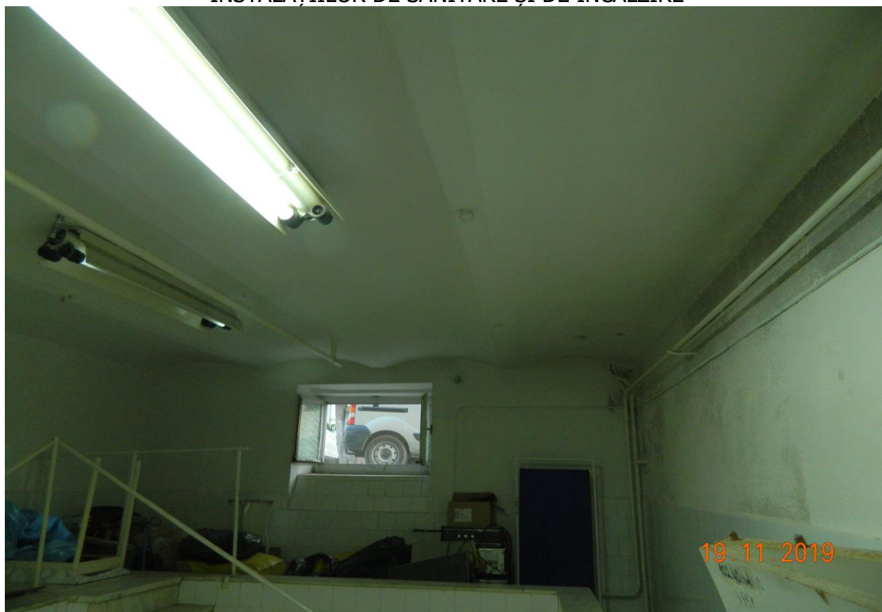
FOTO 6. PLANȘUL DE LA PARTER CU GRINZIȘOARE ȘI BOLȚI DIN ZIDĂRIE
