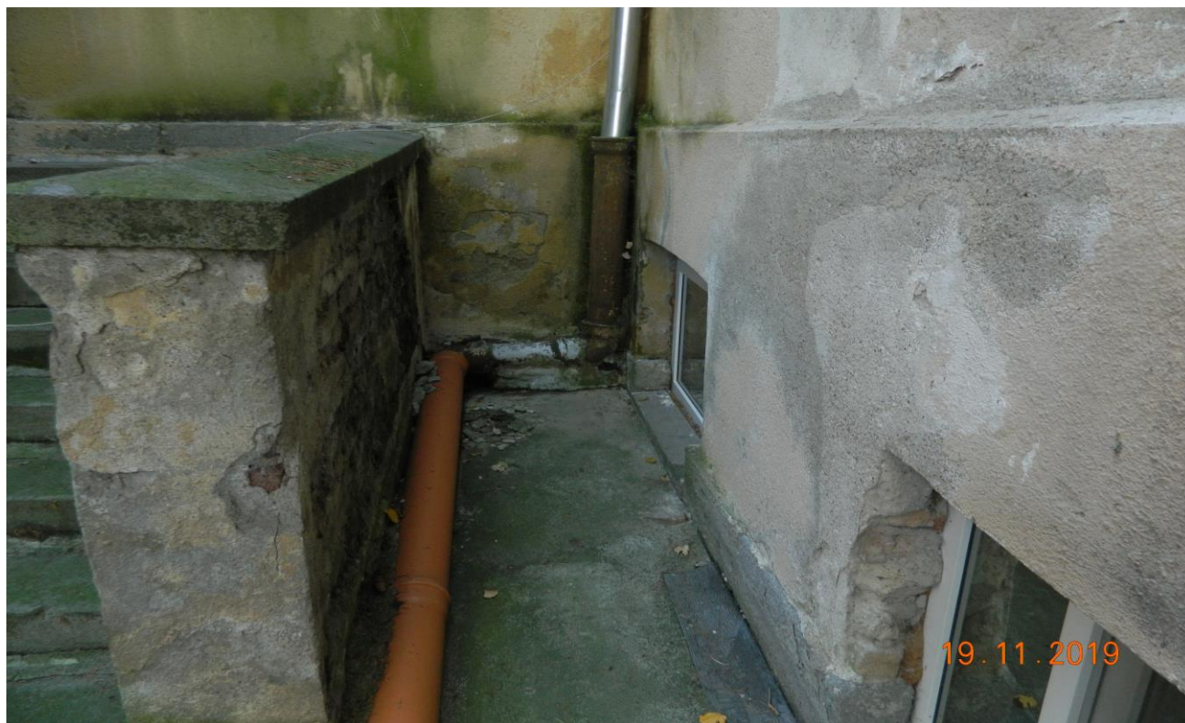
FOTO 9. PRELUAREA APELOR PLUVIALE ÎN TEVI DE EVACUARE DIN FONTĂ SPARTE CARE AU CONDUS APELE LA PEREȚII DEMISOLULUI.
