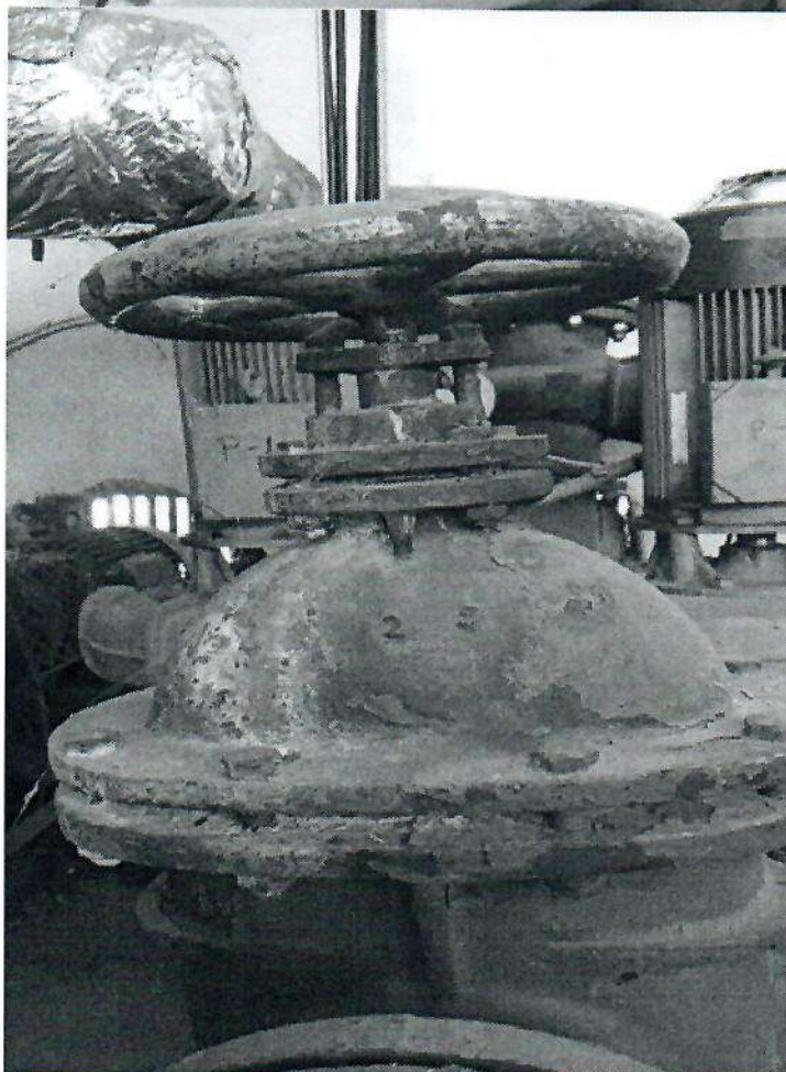
Foto 7,8 – armaturi si instalatii dezafectate
