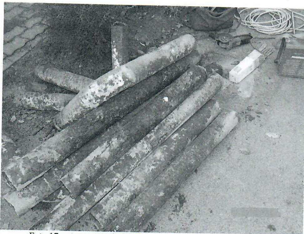
Foto 17 – tronsoane de conducte defecte, dezafectate din instalatie
