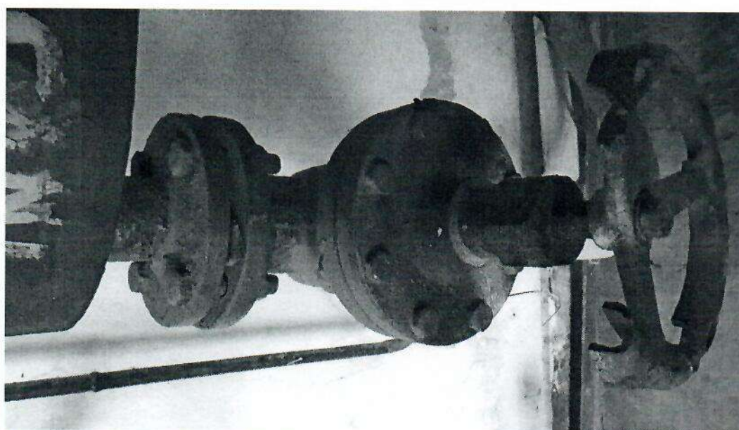
Foto 5,6 – armaturi pe distribuitor
