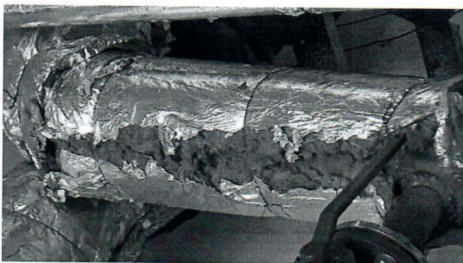
Foto 11 – izolatii termice deteriorate
