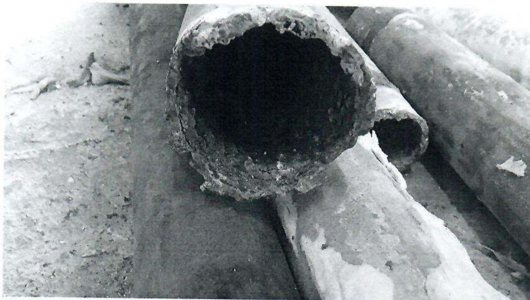
Foto 8 – Conducte deteriorate din circuitul secundar
