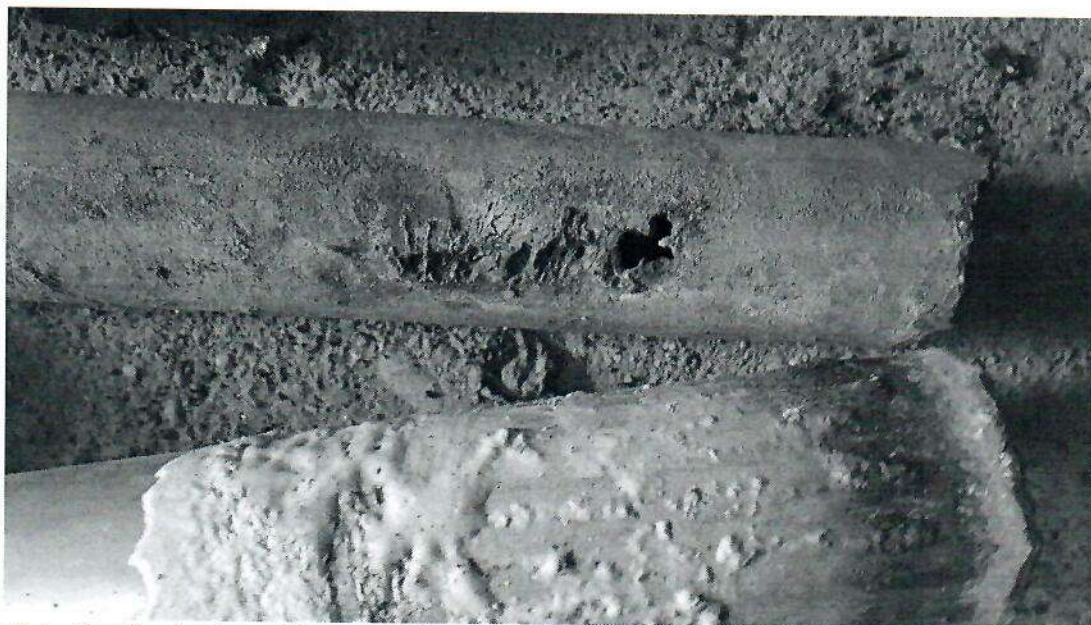
Foto 7 – Conducte vechi extrase din circuitul secundar
