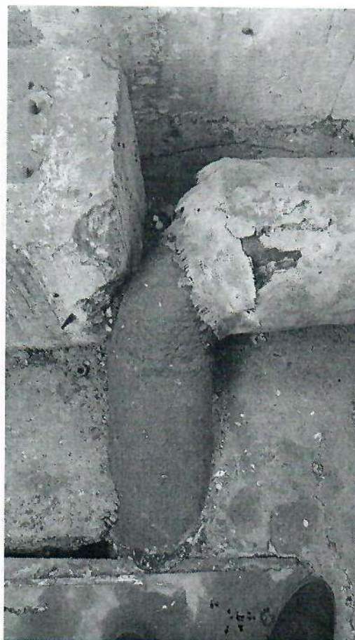
Foto 11 – Detalii cu tevi si izolatii deficitare
