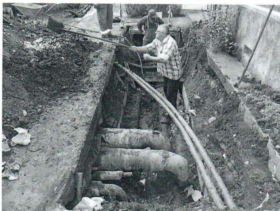
Foto 14 – Retele termice secundar
