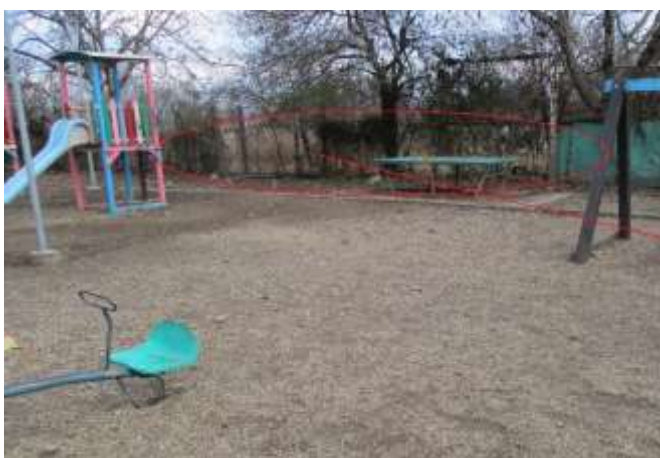
Lipsă panouri gard, stâlpi metalici gard.
