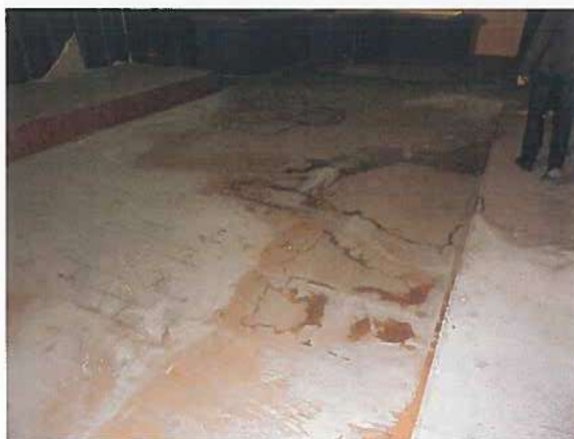
Scurgeri de ape pluviale în sala de cinematograf.
