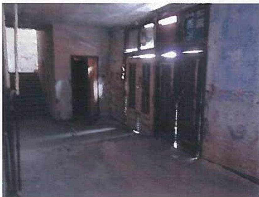
Vedere ieșire cinematograf - uși, pardoseli, tencuieli, finisaje degradări, șape de beton turnate peste pardoseala inițială
