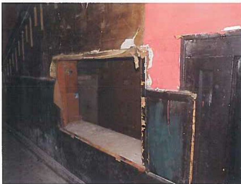
Vedere ieșire cinematograf - uși, pardoseli, tencuieli, finisaje degradări parter
