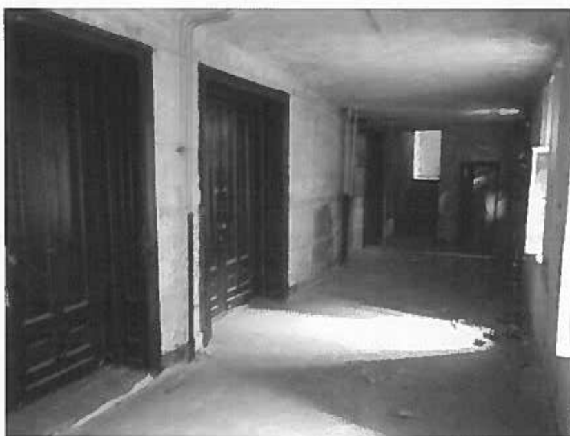
Vedere ieșire cinematograf - uși, pardoseli, tencuieli, finisaje degradări
