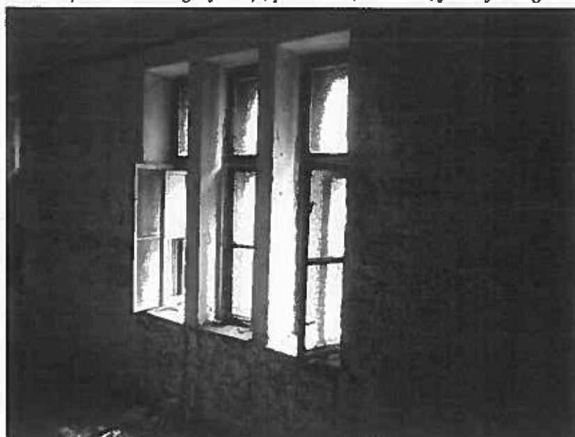
Vedere ieșire cinematograf - ferestre spre str. Goldiș, ferestre, tencuieli, finisaje degradări
