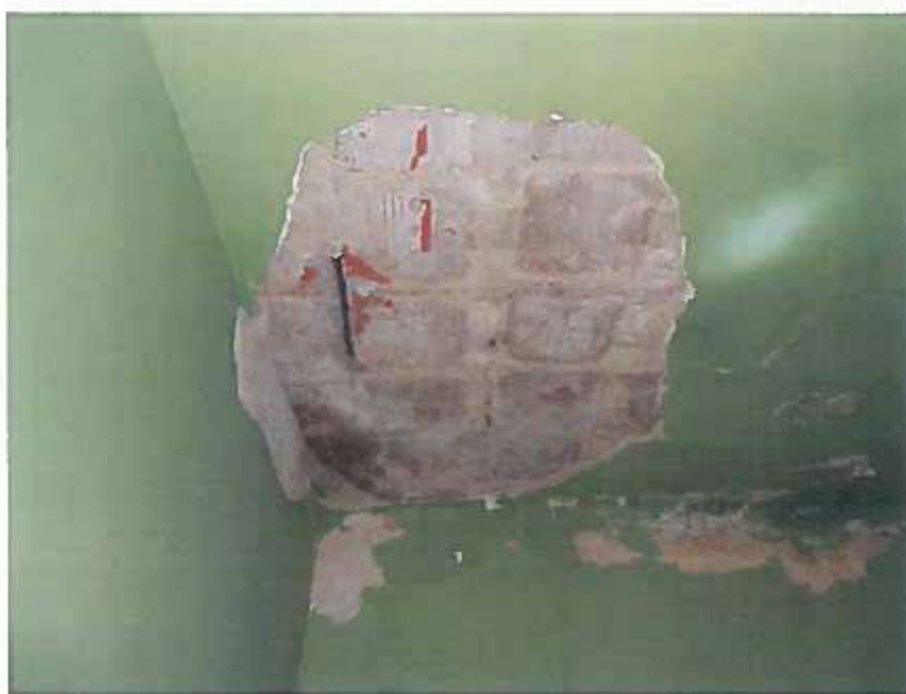
Degradări la planșee, infiltrații, în mai multe zone.
