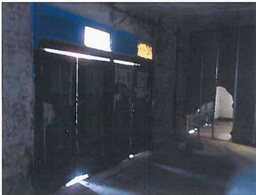
Vedere hol ieșire cinematograf, uși, tencuieli, pardoseli degradate, perete gips carton parazitar.
