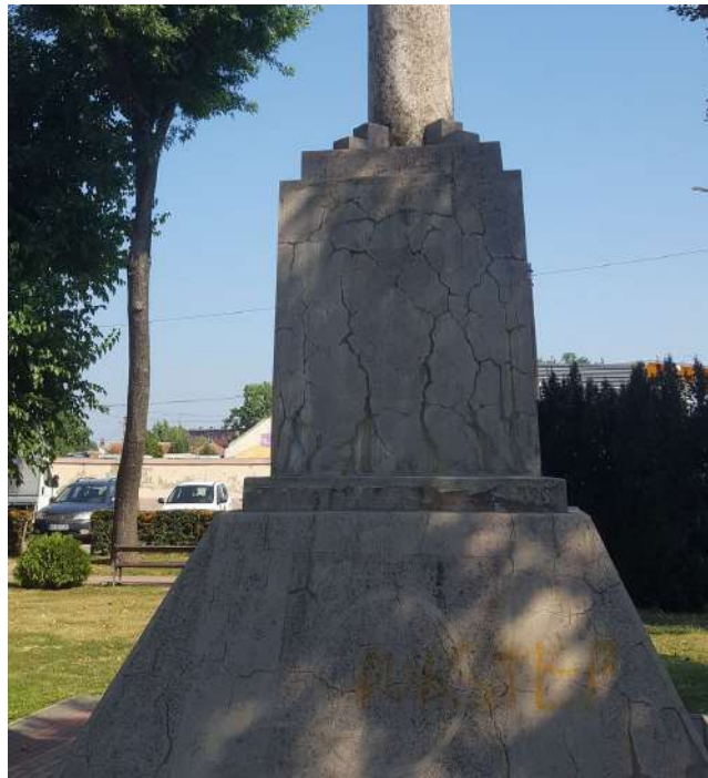
Detaliu crăpături soclu și vandalism- 2018
