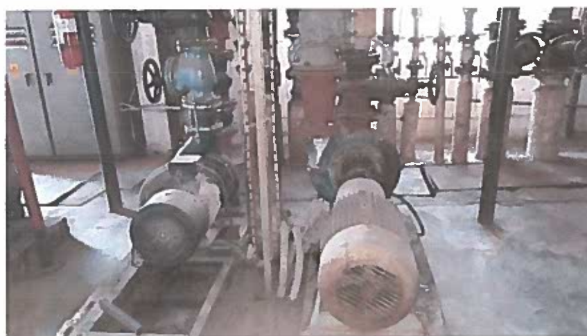
Figura 21: Pompe de circulație principale și de rezervă (Grundfos).
