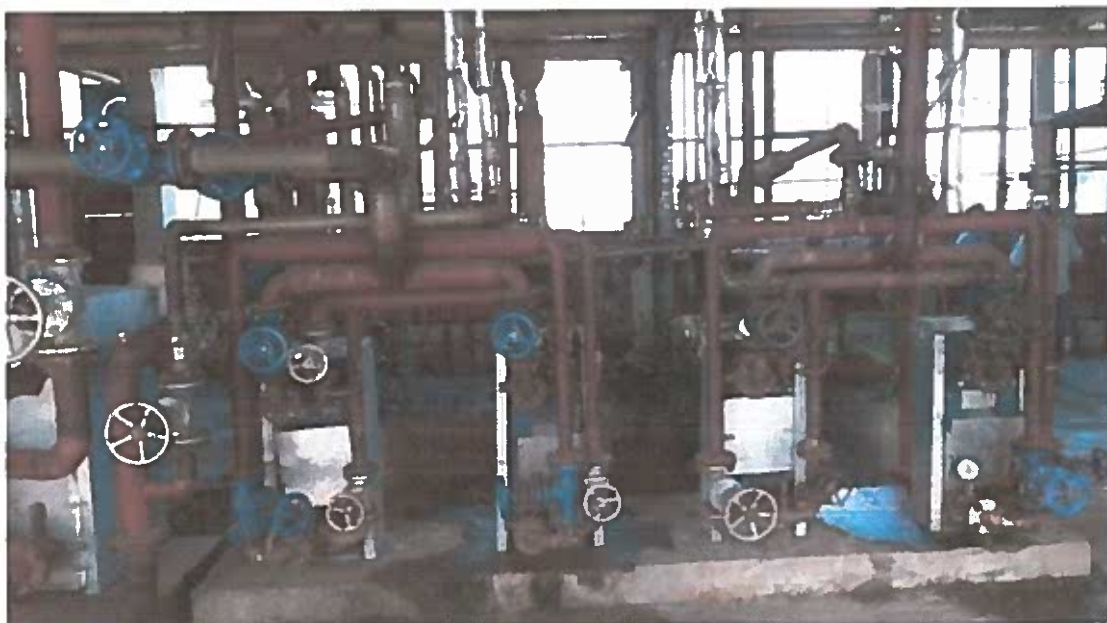
Figura 20: Două schimbătoare pereche pentru apă caldă (o pereche pentru clădirile cu 4 etaje și o a doua pereche pentru clădirile cu 10 etaje).
