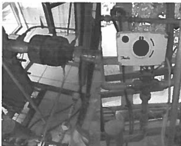
Figura 12: (stânga) Regulator de presiune diferențială de la Regulator Brežice și vană de amestec (dreapta) VRG3 cu servomotor de acționare AMV de la Danfoss în fața schimbătorului de apă caldă.
