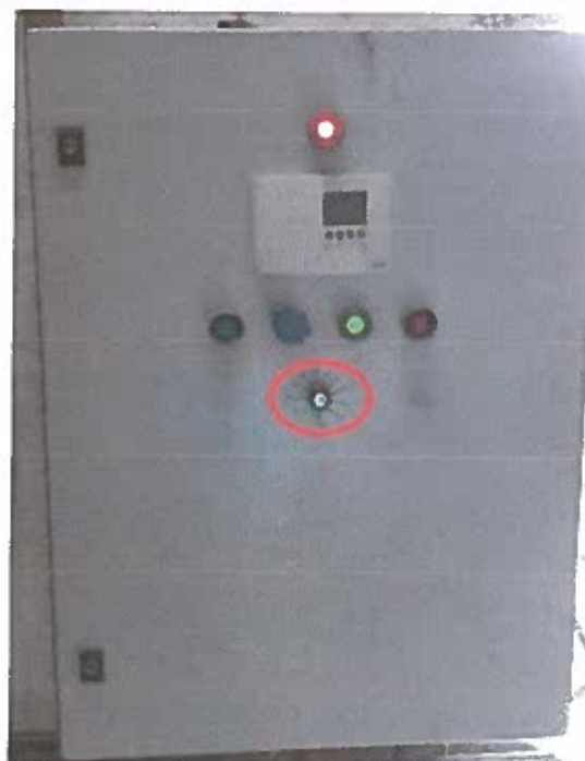
Figura 19: Controler ECL 301 și buton pentru setarea temperaturii în sistemul secundar.
