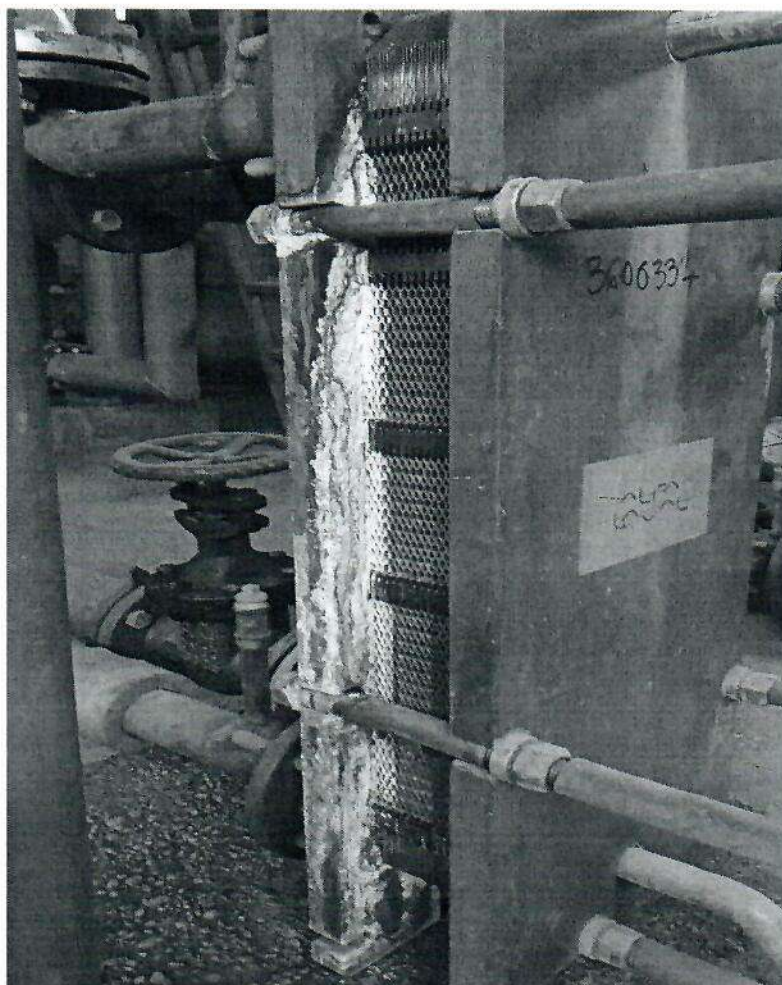
Foto 2 – Starea precara a schimbatoarelor de caldura cu placi
