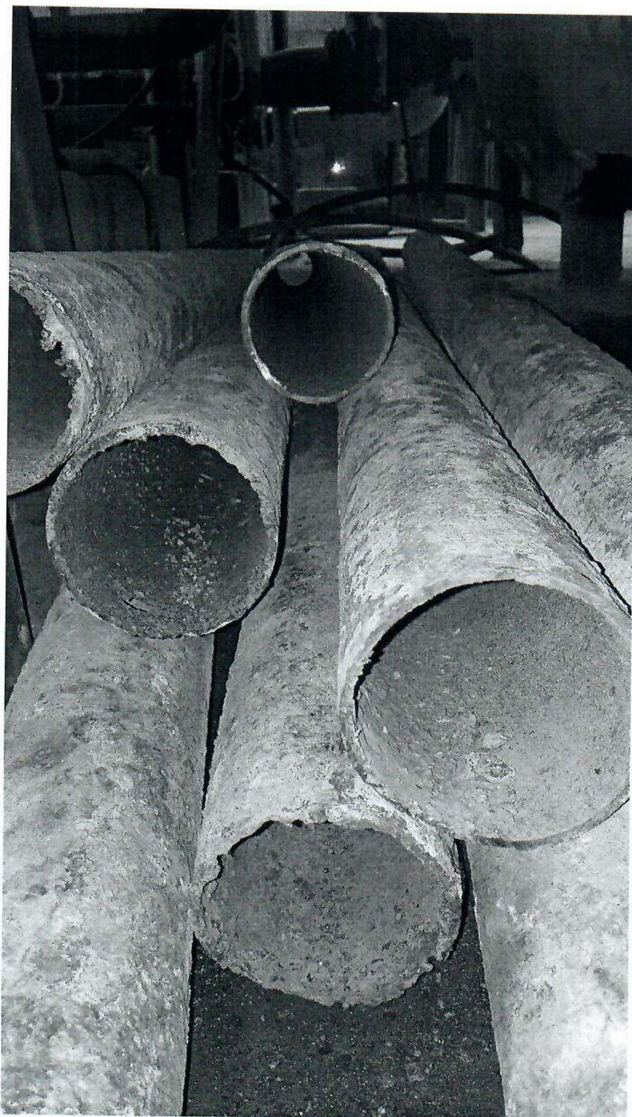
Foto 10 – Tronsoane de teava corodate extrase din instalatie
