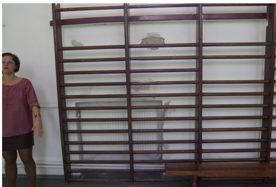
Probleme legate de igrasia care se evidențiază pe pereții interiori
