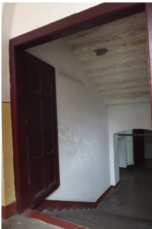
Probleme legate de igrasia care se evidențiază pe pereții interiori
