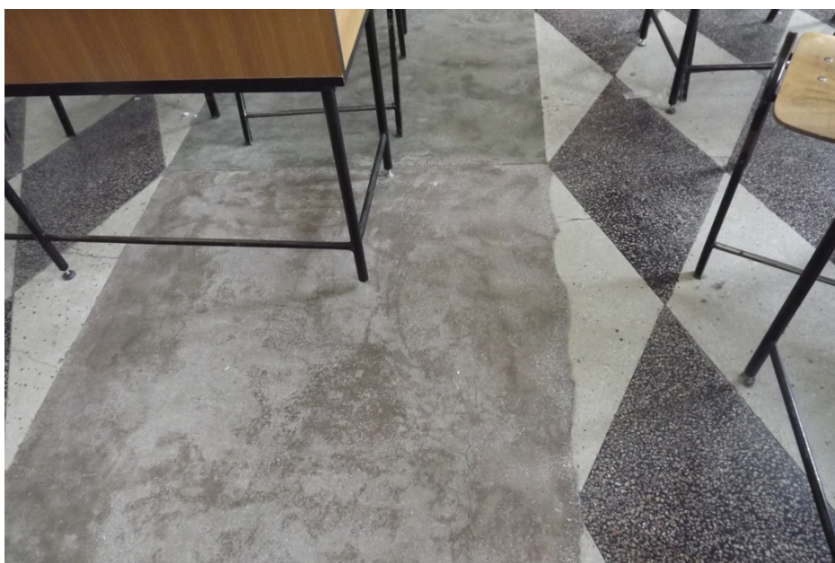
Pardoselile realizate in anii 1968 din plăci de ciment mozaicat alb gri, deteriorate pe porțiuni
