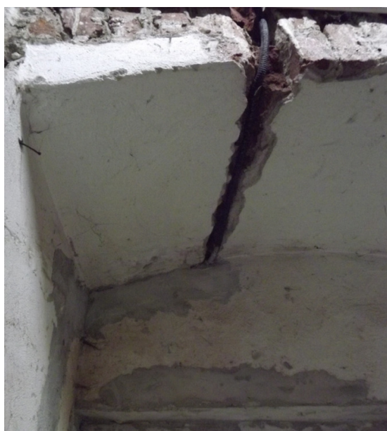
Probleme legate de degradări în zonele dintre axele 15-16 pe axul B
