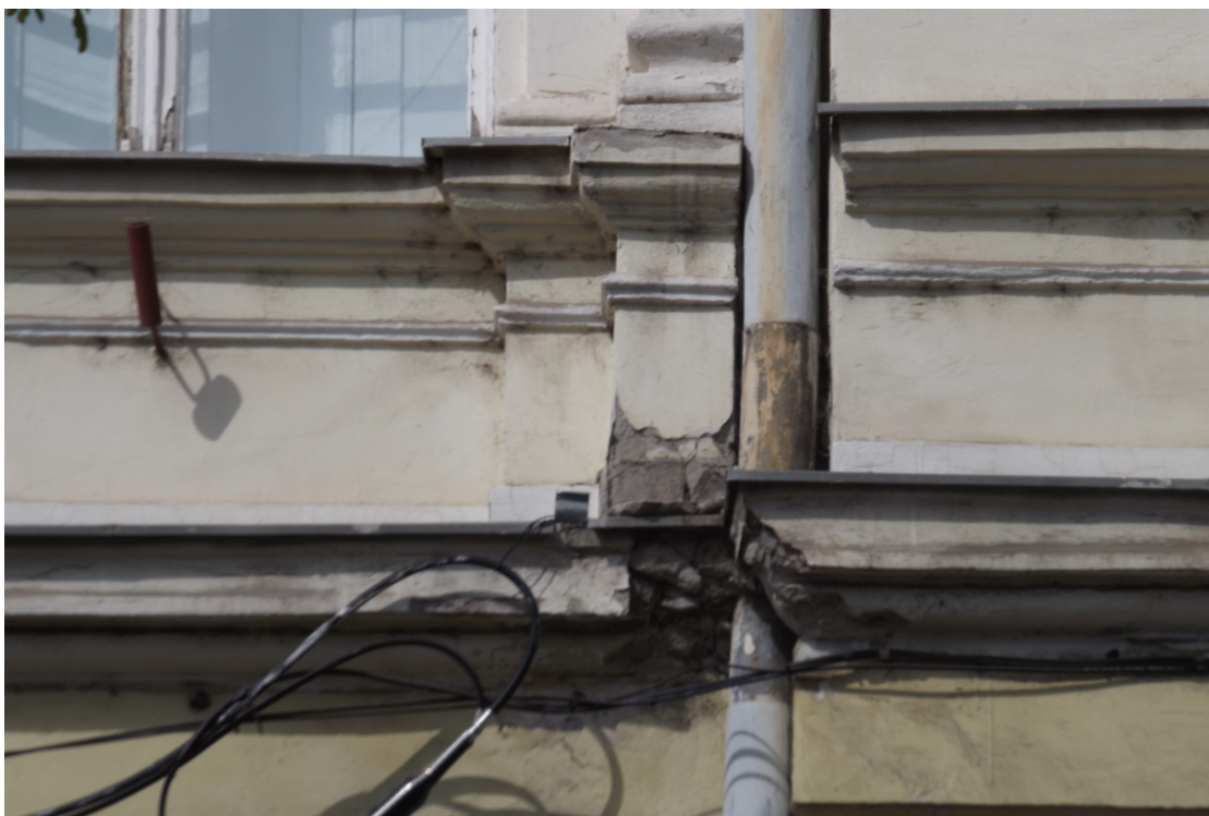
Distrugeri la îmbinarea burlanelor cu brăurile ornamentale
