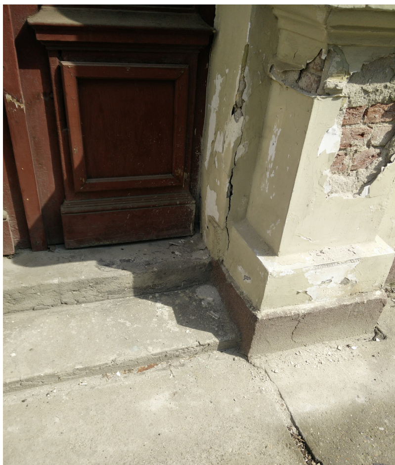
Tencuială căzută la zona subsolului la fațada principală
