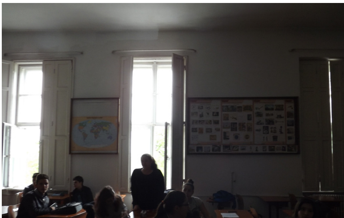
Tâmplărie lemn – ferestre și obloane interioare care necesită reparații
