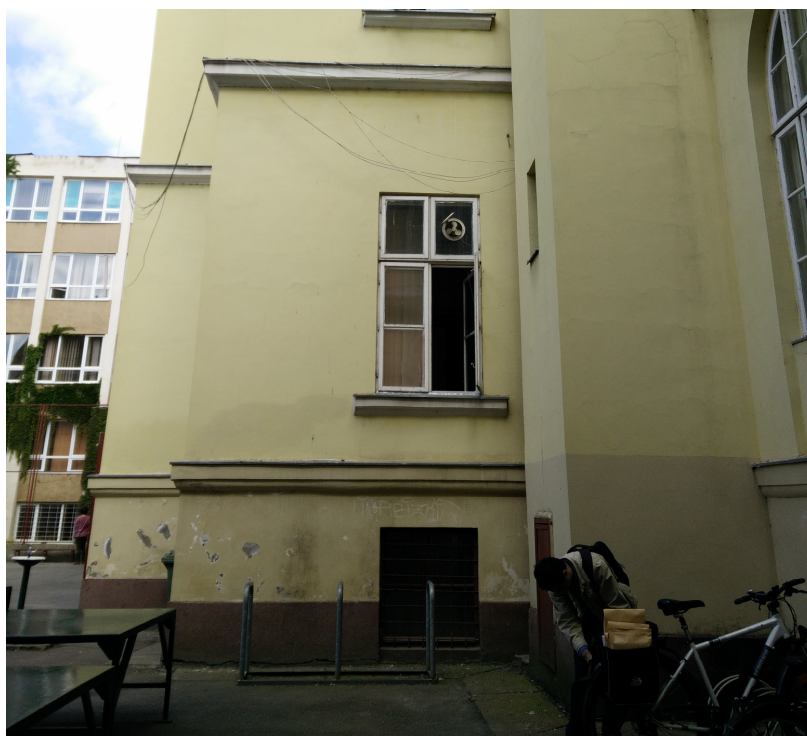
Tencuială căzută la zona subsolului în curtea școlii
