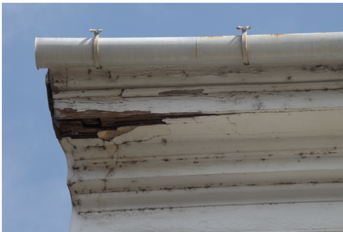
Brâu cornișă cu degradare si desfacere a lemnăriei închiderii
