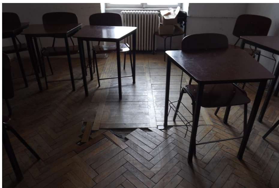
Pardoseli de parchet deteriorate in sălile de clasă.
