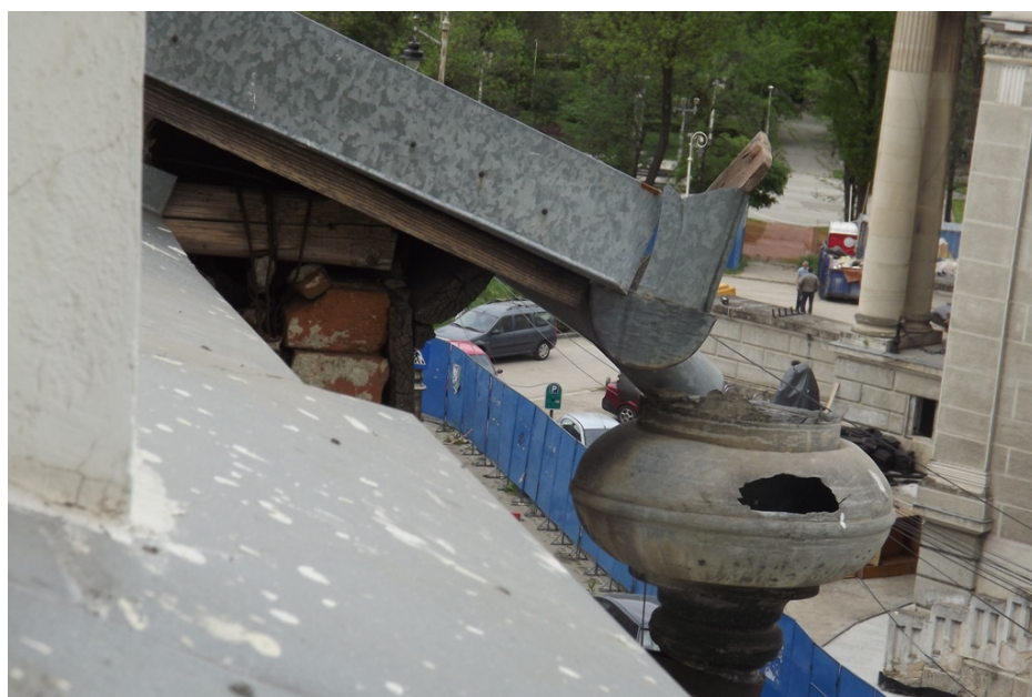
Tinichigerie cu gargui metalic deteriorat
