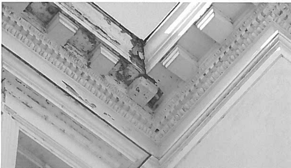
Infiltrații ale apelor pluviale la atice, streașină, cu deteriorare ale tencuielilor,
