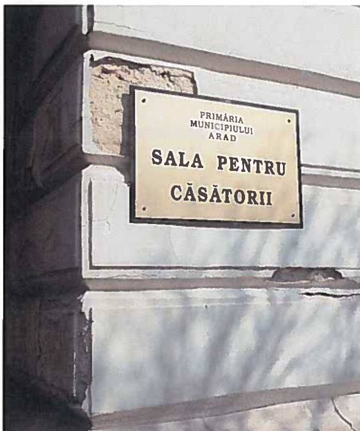
Deteriorări ale bosajelor cu scorojiri ale tencuielilor, gleturilor, vopsitoriilor
