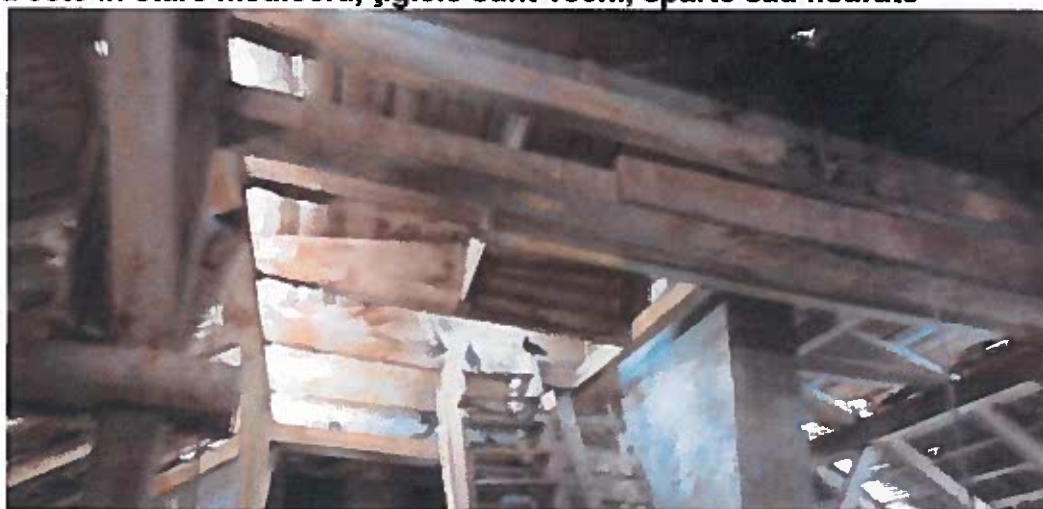
Pane deteriorate cu infiltrații de apă pluvială.
