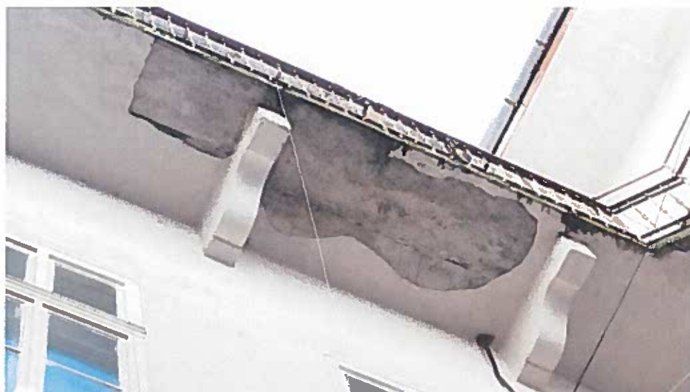
Deteriorări ale balcoanelor cu infiltrații de ape pluviale
