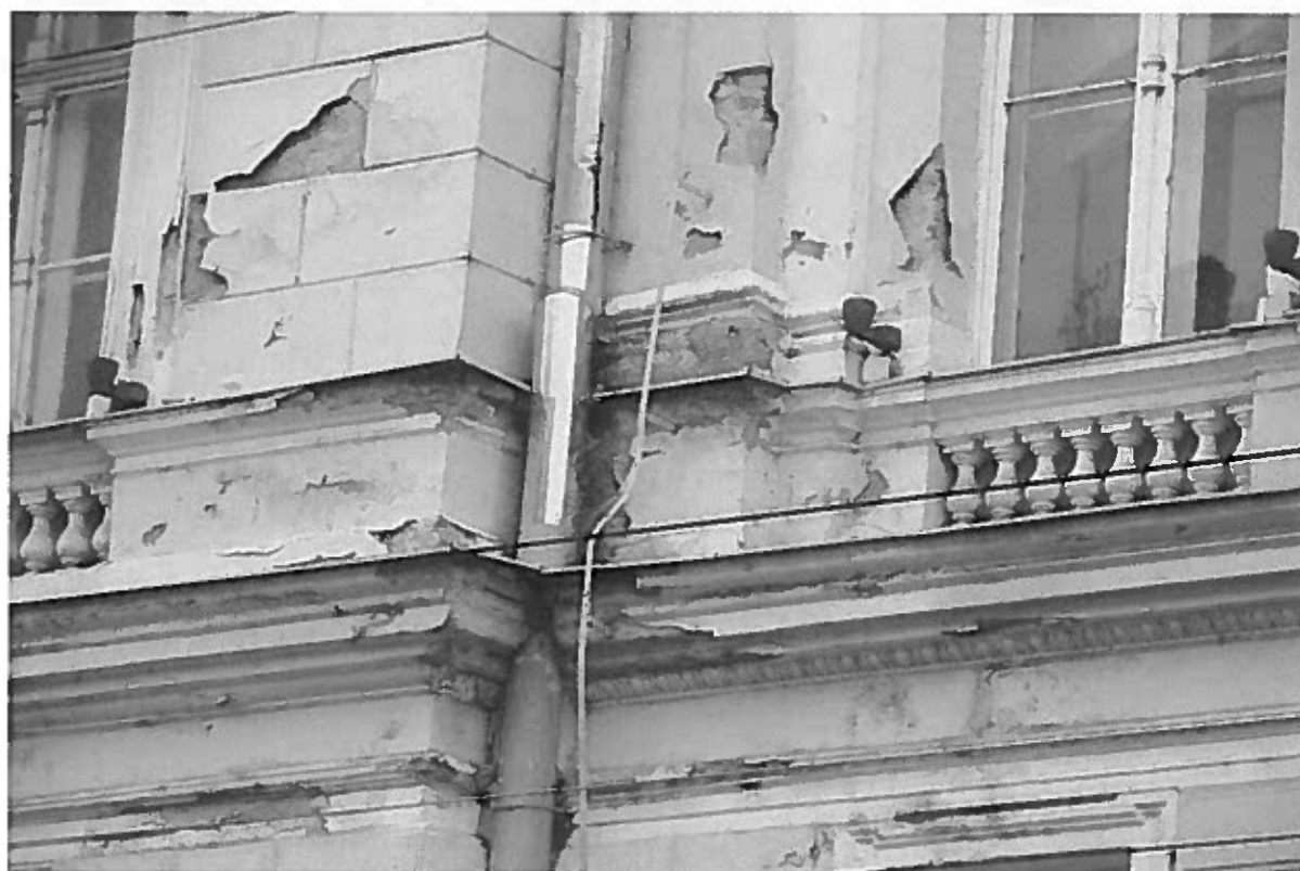
Deteriorări ale fațadei cu scorojiri ale tencuielilor, gleturilor, vopsitoriilor
