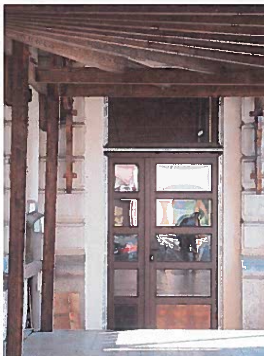
Apariția unor construcții parazitare neconforme cu arhitectura imobilului
