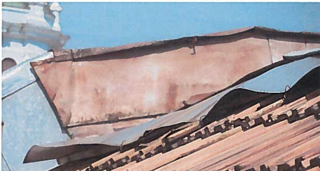
Tinichigerie și învelitoare de tablă deteriorate
