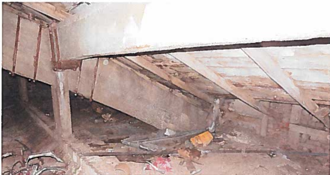
Elementele de legătură ale șarpantei cu grinzile de beton sunt ruginite, astereaala de sub învelitoarea de tablă prezintă infiltrații ale apelor pluviale
