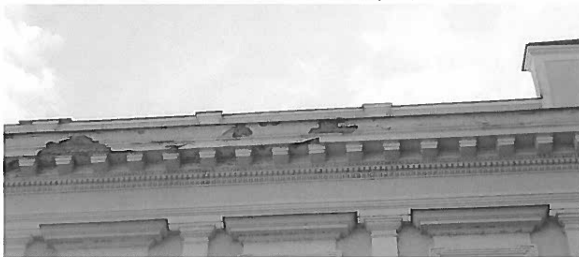
Cornișa degradată prin infiltrarea apei de la racordul învelitoarei cu aticul
