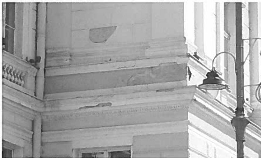
Deteriorări ale fațadei - Tencuială și vopsea căzută
