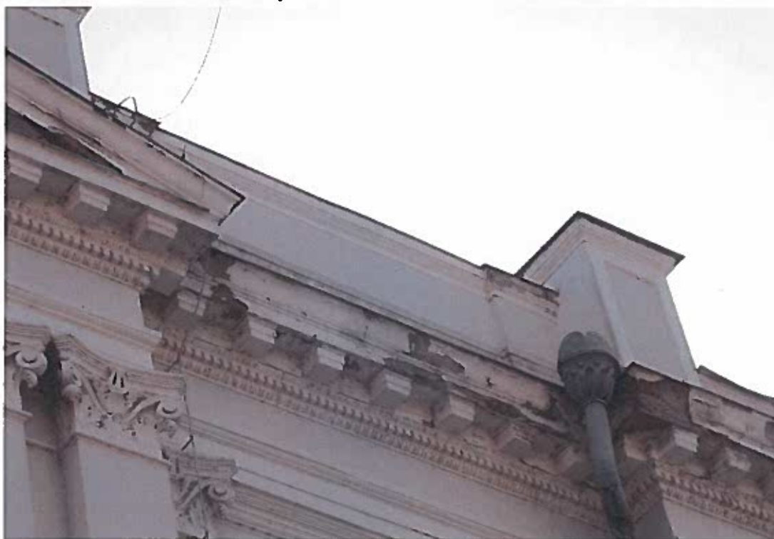
Tinichigerie distrusă cu degradări ale profilaturilor
