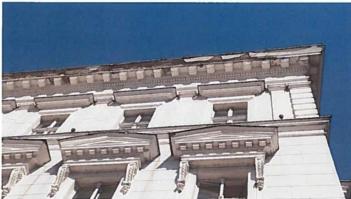
Tencuieli si profilaturi distruse în zona aticelor
