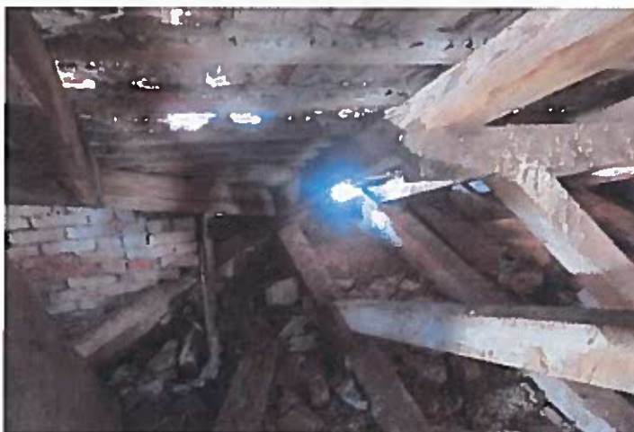
Șarpanta este în stare mediocră, țiglele sunt vechi, sparte sau fisurate
