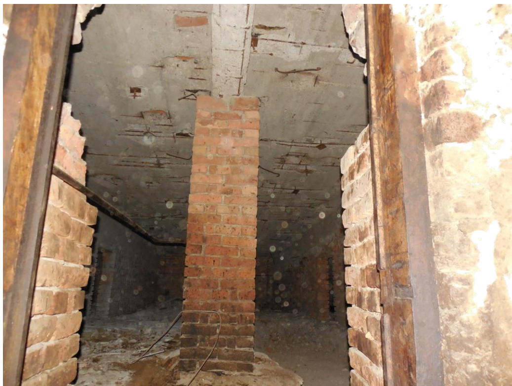
Intervenții neconforme – planșeu cu armătura neacoperită
