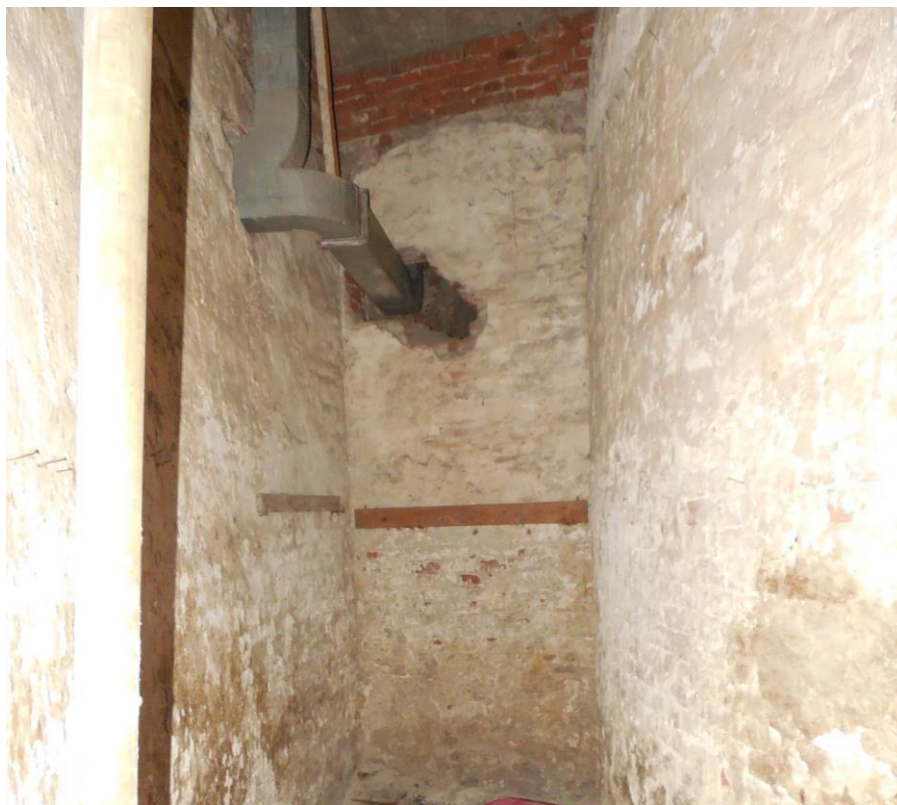
Infiltrații și igrasie pereți la subsol
