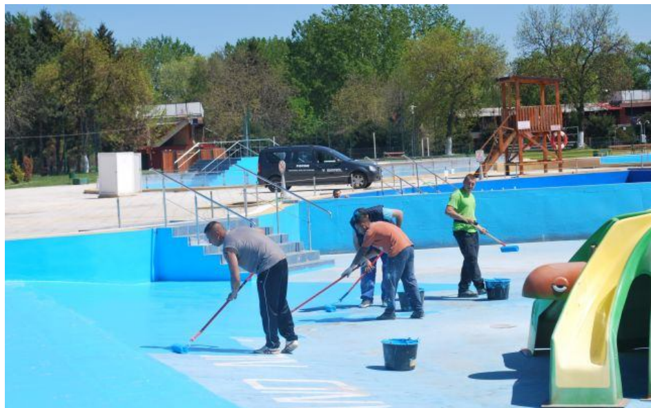
Vopsirea bazinelor cu vopsea albastra in 2007. Propunerea de inlocuire a acesteia cu gresita.
